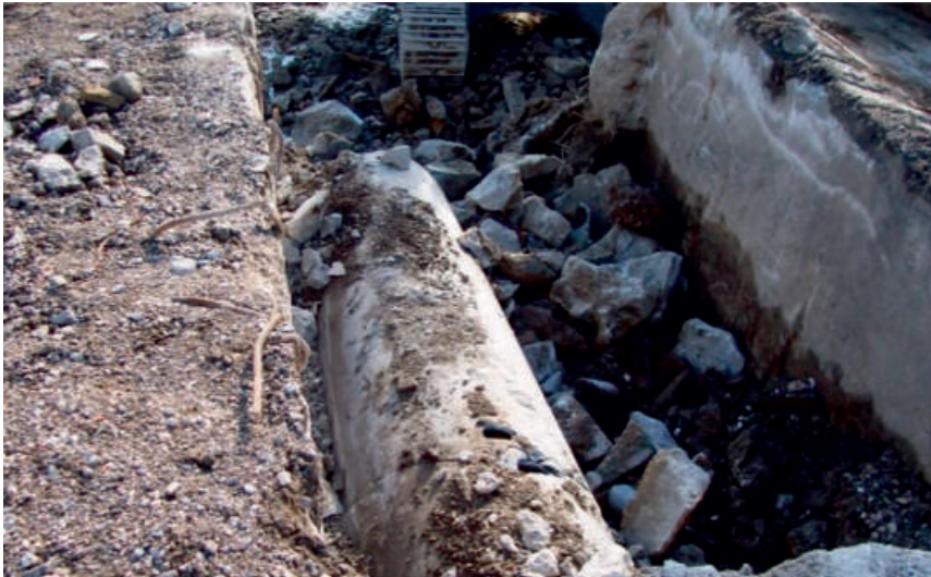
Figura 50: Tubazione in cemento-amiante; vedi Riferimenti alle immagini
