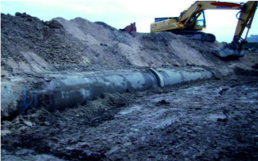
Figura 45: Tubazione in cemento-amianto; vedi Riferimenti alle immagini
