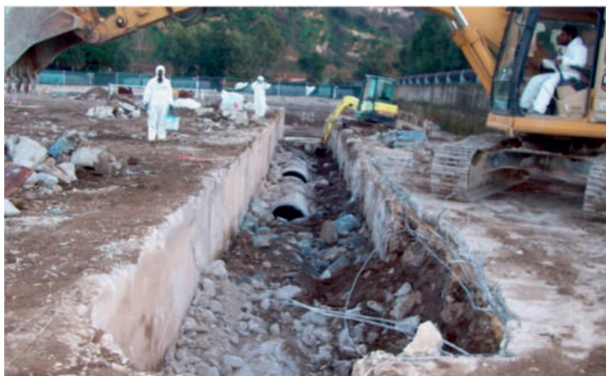
Figura 51: Tubazione in cemento-amianto; vedi Riferimenti alle immagini
