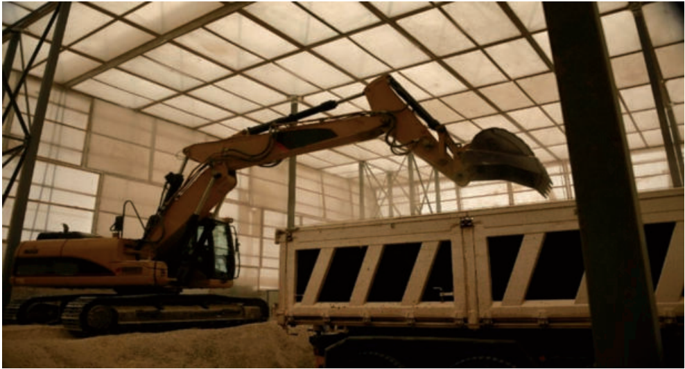
Figura 47: Movimentazione suoli con Mca in ambiente confinato statico e dinamico; vedi Riferimenti alle immagini
