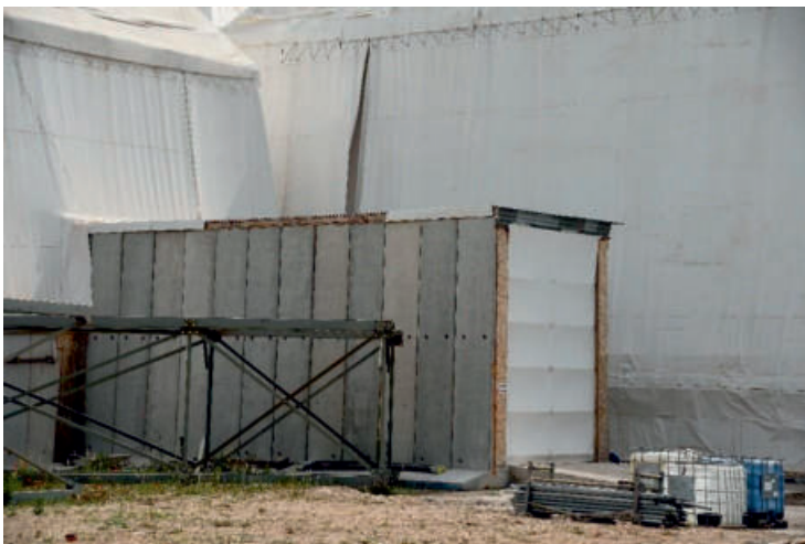
Figura 75: Unità di decontaminazione dei materiali e dei mezzi di grandi dimensioni - vista esterna; vedi Riferimenti alle immagini
